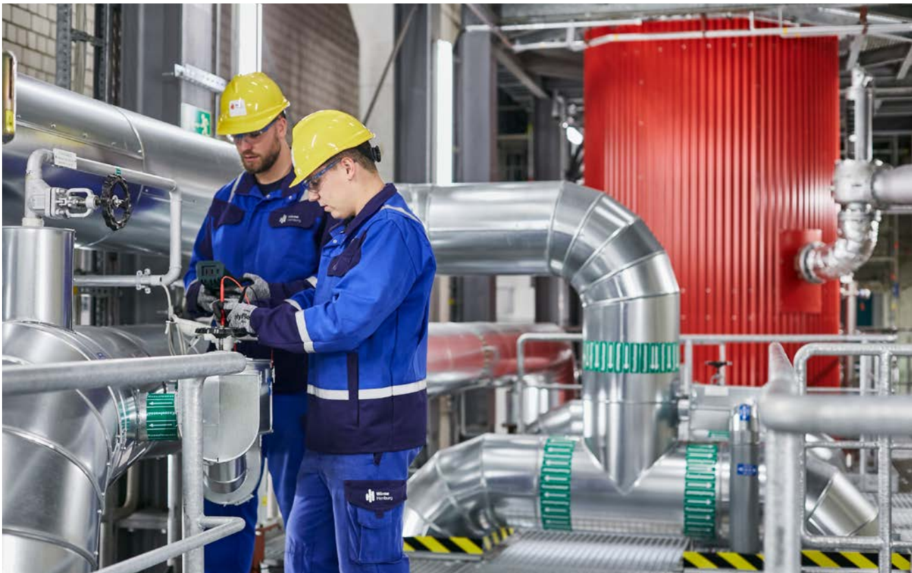
Am Standort des Umspannwerkes Karoline im Hamburger Karolinenviertel wandelt eine Power-to-Heat-Anlage Windstrom in Wärme um. Foto: Wärme Hamburg/Rolf Otzipka
