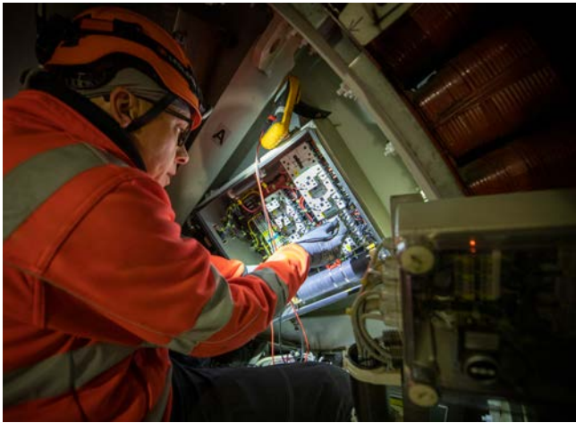
Servicetechniker bei der Wartung auf einer Enercon E-66 in Nechlin. Foto: Enertrag/Silke Reents
