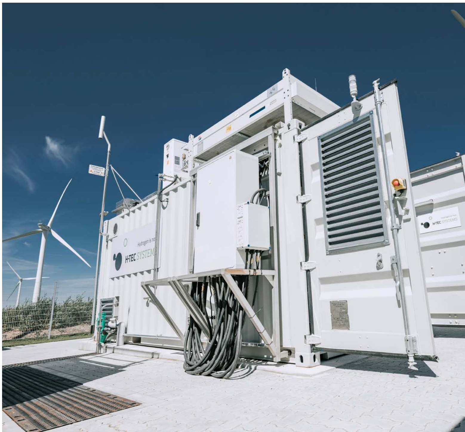
Die bei der Elektrolyse entstehende Abwärme wird zum Beheizen von Gebäuden genutzt. Somit erreicht die Elektrolyse einen Wirkungsgrad von mehr als 95 Prozent. Foto: GP Joule
